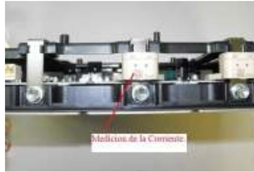
Figura 11. Sensores de Corriente dentro del Inversor.
